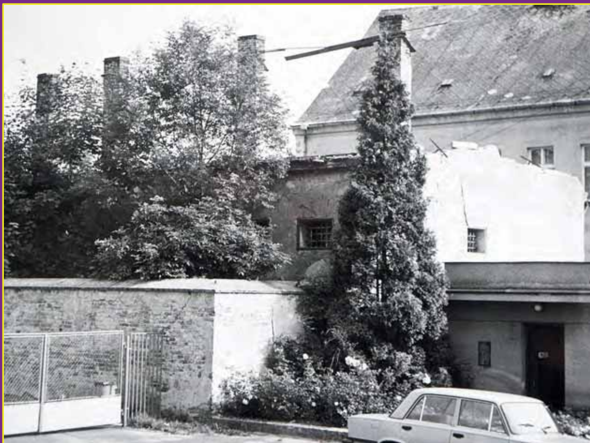
Ruina věznice okresního soudu Tachov před demolicí v roce 1986 (foto: SOkA Tachov)
