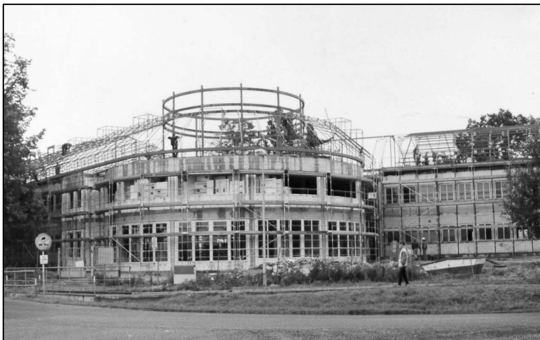
Budování školského objektu Institutu vzdělávání VS ČR ve Stráži pod Ralskem (foto: KDH)
